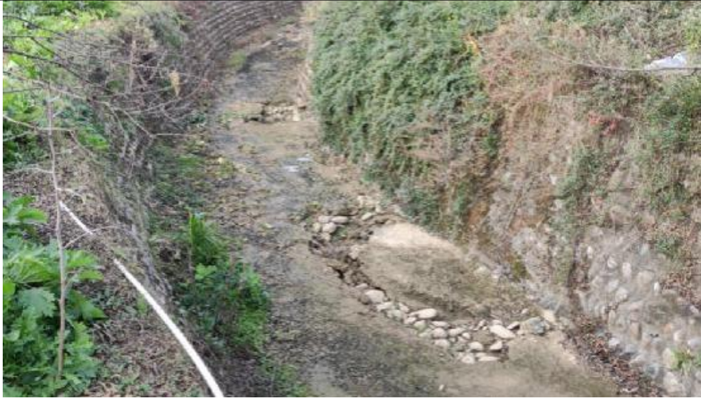
图 3-3 部分河道河床冲刷严重
