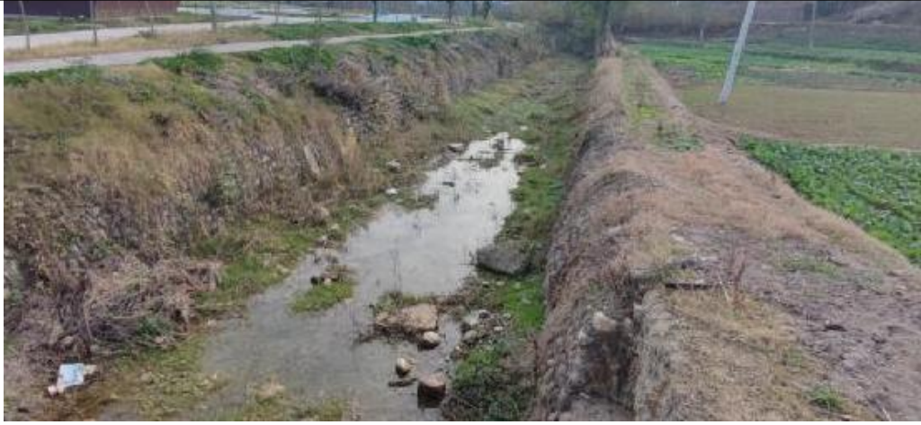
图 3-1 现有挡墙不满足防洪标准
