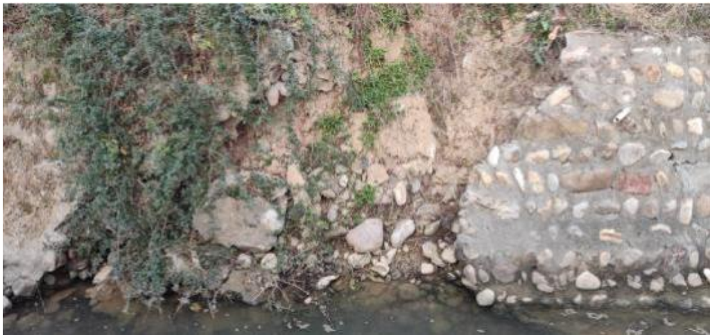
图 3-2 部分挡墙年久失修垮塌
